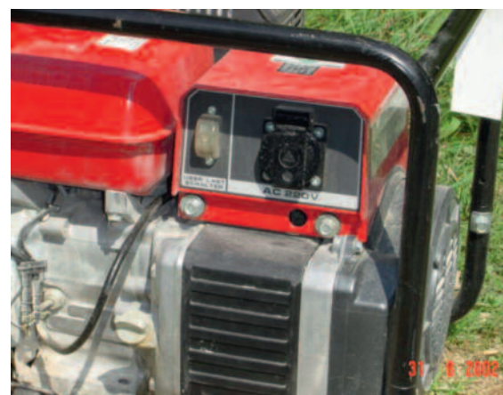
Abbildung 5: Stromerzeuger mit Schutzmaßnahme Schutztrennung
