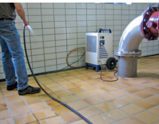
Abbildung 2: Reinigungsarbeiten in einem Wasserwerk mit Strahlwassereinwirkung auf elektrische Anschlussleitung und Betriebsmittel
