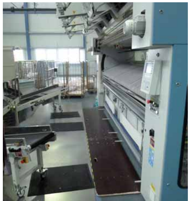
Beim Verlassen des Arbeitsplatzes müssen die Mangelgrube abgedeckt und die Zuführbänder zur Seite geschoben werden.
