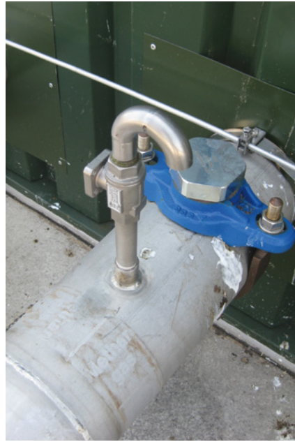
Neuaufnahme: Manuelle Probenahmestelle für Gas.
