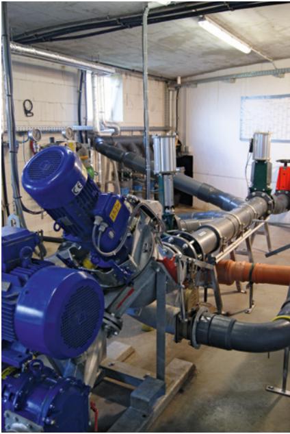
Neuaufnahme: Räume mit substratführenden Anlagenteilen.
