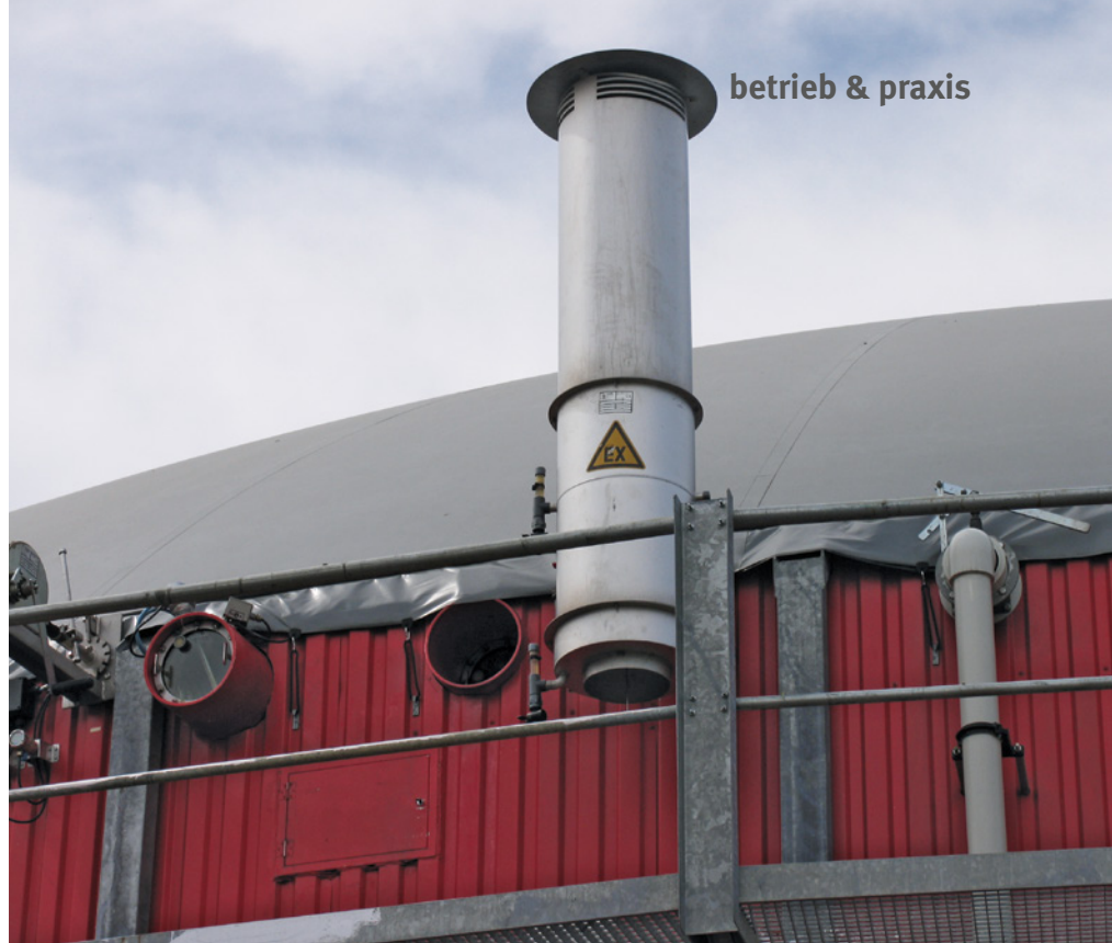
Die Zoneneinteilung für die Umgebung der Gasüberdrucksicherung orientiert sich nunmehr an der Abblaseleistung.
