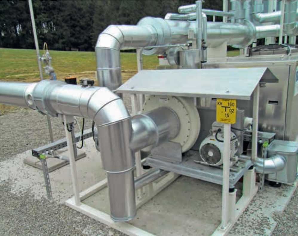
Explosionsgefahr besteht auch an der Einspeiseleitung
