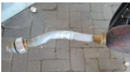
Bild 6: Verformter Füllschlauch einer MDS-Blase durch Umschlagen in der Rohrleitung im Mitteldruckbereich – Ursache: fehlender Druckausgleich beim Ziehen der Blase
