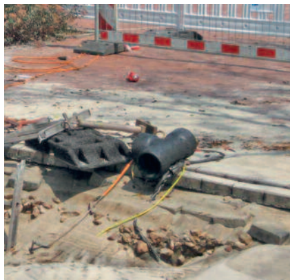
Bild 2: Zustand der Baugrube nach dem Unfall mit geschmolzener Aluminium-Leiter und eingeschwemmtem Sand.
