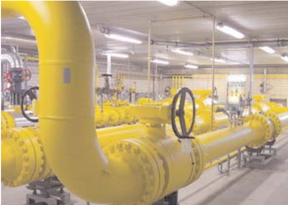
Begehrbarer Aufstellungsraum einer GDRM-Anlage
