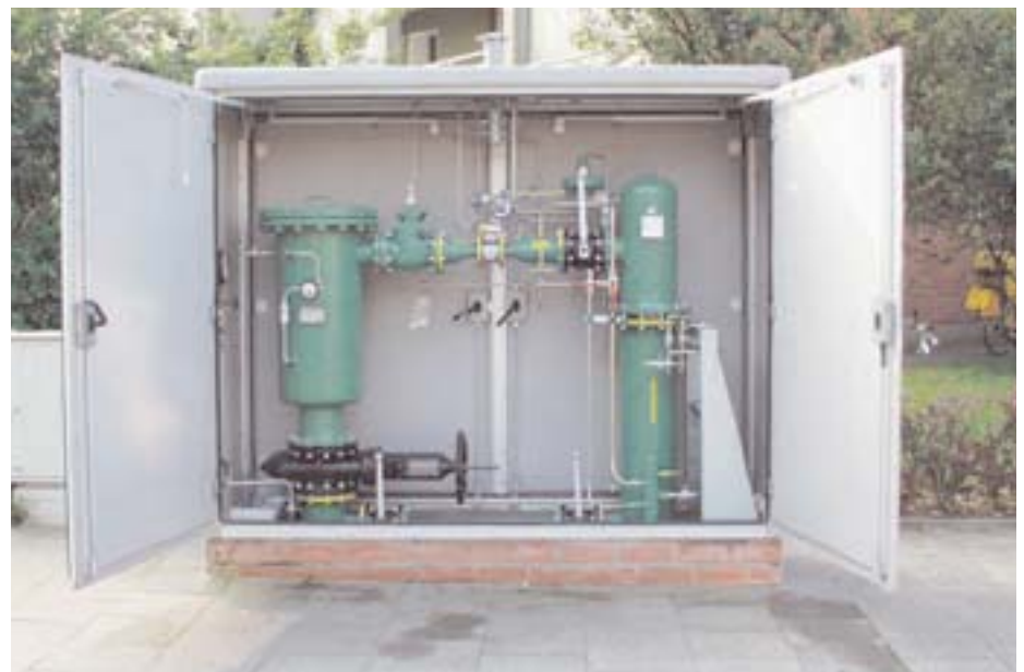
Schrankanlage, nicht begehrbar
