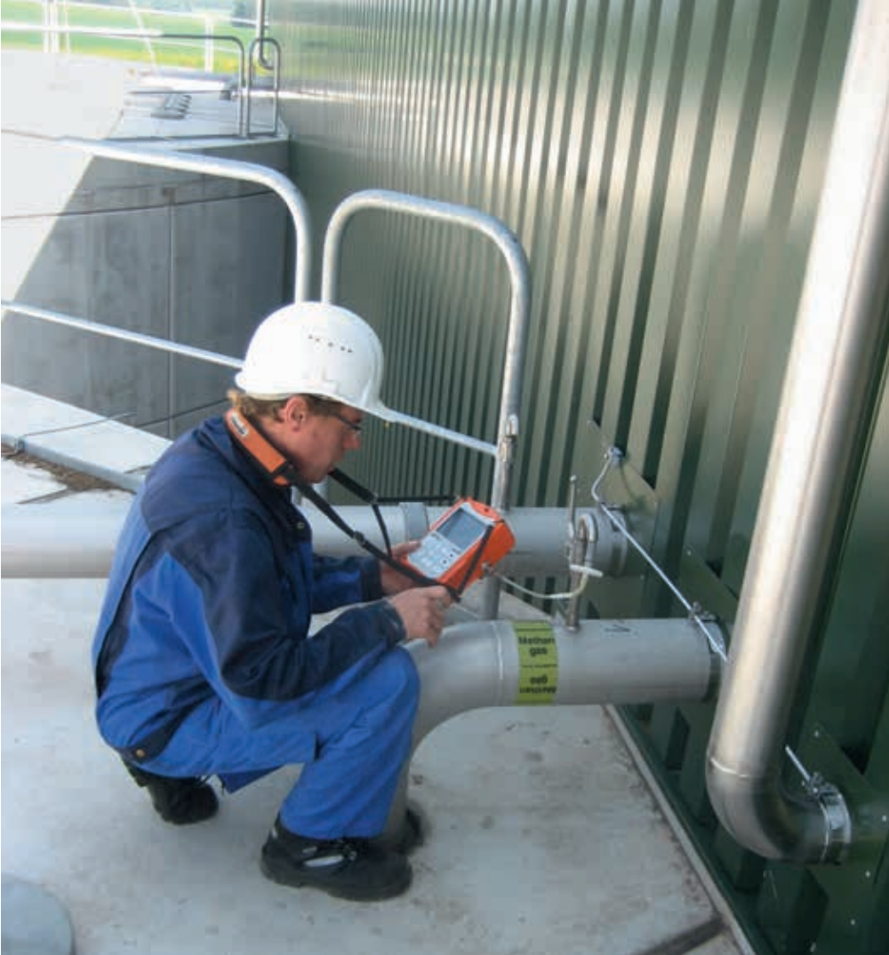
Messung der Rohbiogaszusammensetzung am Fermenter
