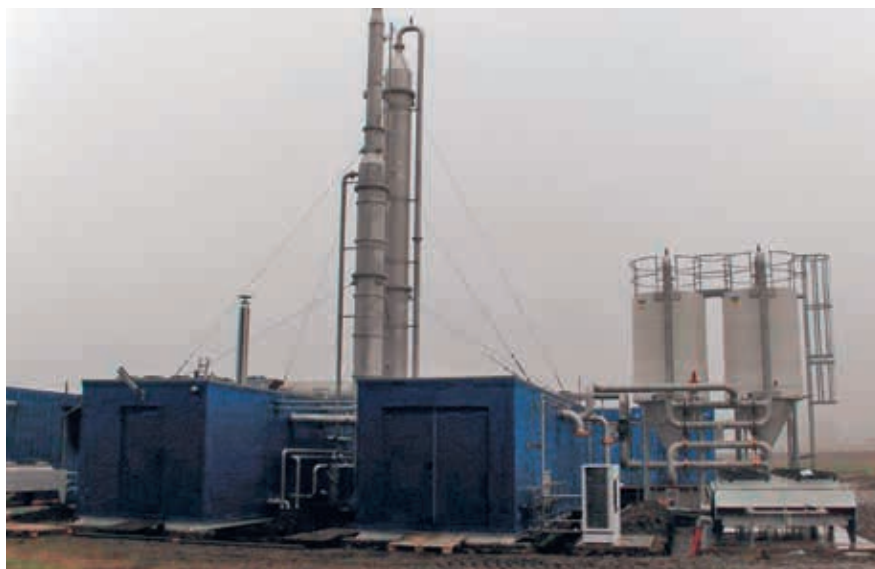
Biogasaufbereitungsanlage der Stadtwerke Rhede GmbH
