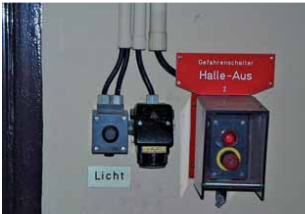
Elektroinstallation und -betriebsmittel in explosionsgeschützter Ausführung.
