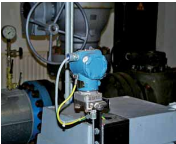
Transmitter im Ex-Bereich mit separatem Potenzialausgleich.
