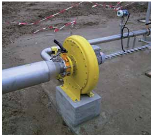
Vor Inbetriebnahme werden Montage, Installation, Aufstellbedingungen und sichere Funktion des Ventilators in explosionsgeschützter Ausführung überprüft.
