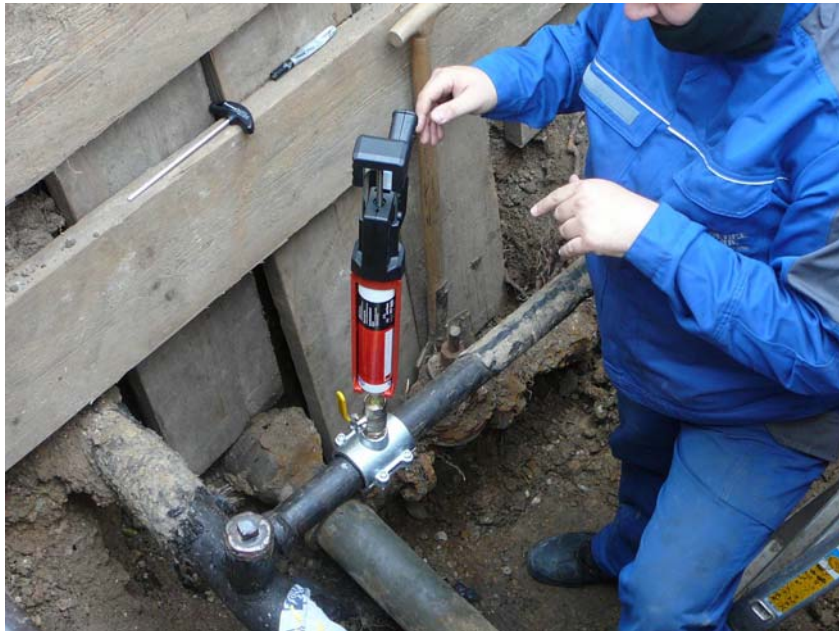
Entwicklung und Erprobung eines neuen Verfahrens zur Abtrennung von Gas-Hausanschlussleitungen unter Verwendung von Polymerschäumen
