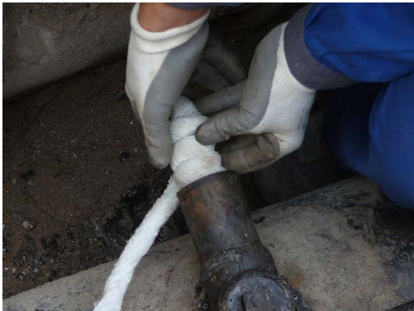
Entwicklung und Erprobung eines neuen Verfahrens zur Abtrennung von Gas-Hausanschlussleitungen unter Verwendung von Polymerschäumen
