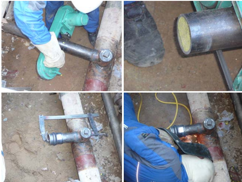
Entwicklung und Erprobung eines neuen Verfahrens zur Abtrennung von Gas-Hausanschlussleitungen unter Verwendung von Polymerschäumen
