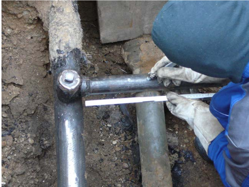
Entwicklung und Erprobung eines neuen Verfahrens zur Abtrennung von Gas-Hausanschlussleitungen unter Verwendung von Polymerschäumen
