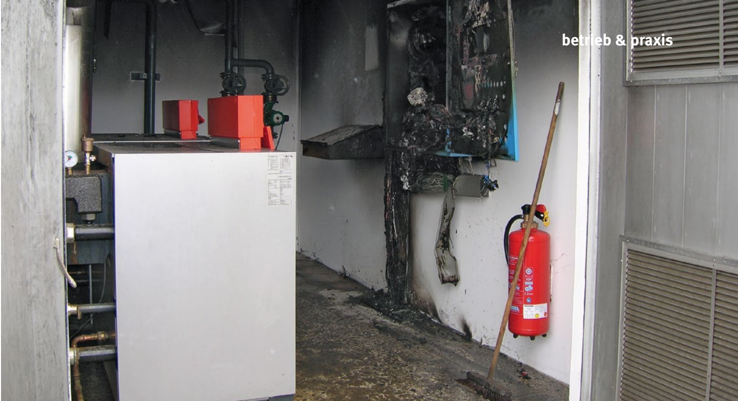
Der Heizraum der Gas-Übernahmestation nach dem Brand.
