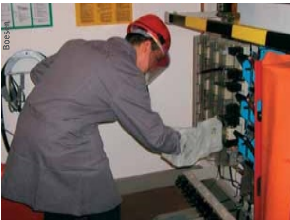
Es gibt elektrotechnische Arbeiten, die ohne besondere technische und organisatorische Maßnahmen unter Spannung ausgeführt werden können und dürfen. Zu diesen elektrotechnischen Arbeiten gehört z. B. das Herausnehmen oder Einsetzen von nicht gegen direktes Berühren geschützten NH-Sicherungseinsätzen (< 1000 V Nennspannung).
