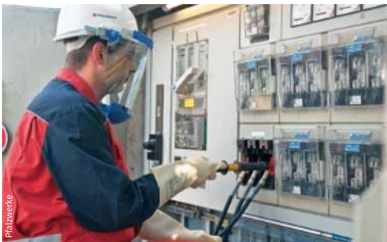
Das Anschließen von Notstromaggregaten gehört zu den Tätigkeiten, die von der berufsgenossenschaftlichen Regel BGR A3 erfasst werden und besondere technische und organisatorische Maßnahmen erfordern.
