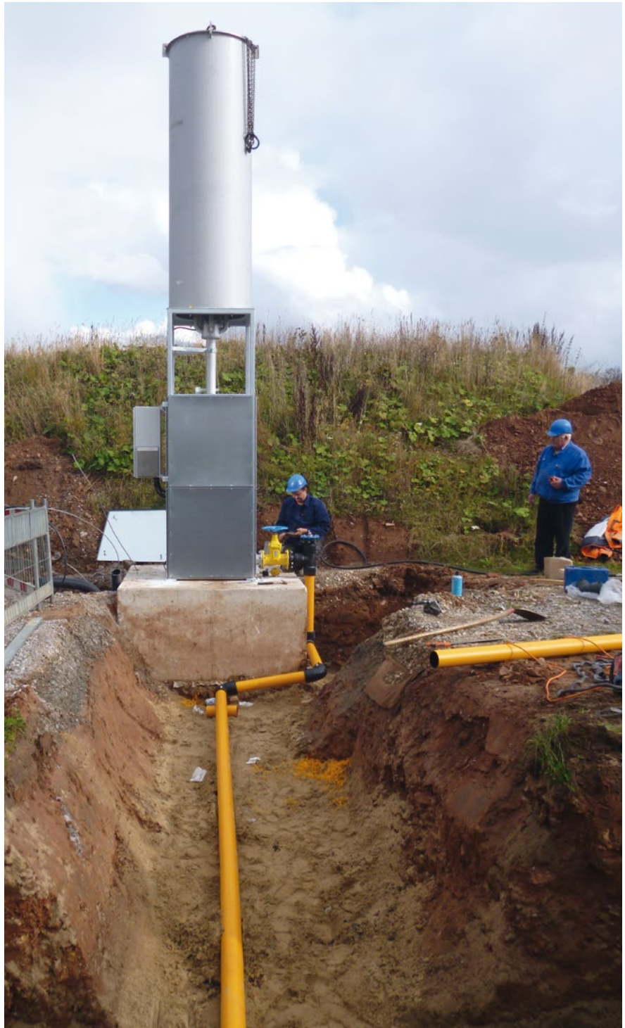
Biologische Arbeitsstoffe können sich auch in Rohbiogasleitungen ablagern. Bei Montagearbeiten können Beschäftigte in Kontakt mit dem belasteten Kondensat kommen.
