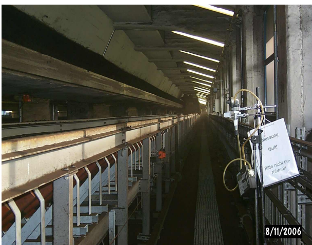
Abbildung 1: Messpunkt am Förderband einer Bekohlungsanlage
