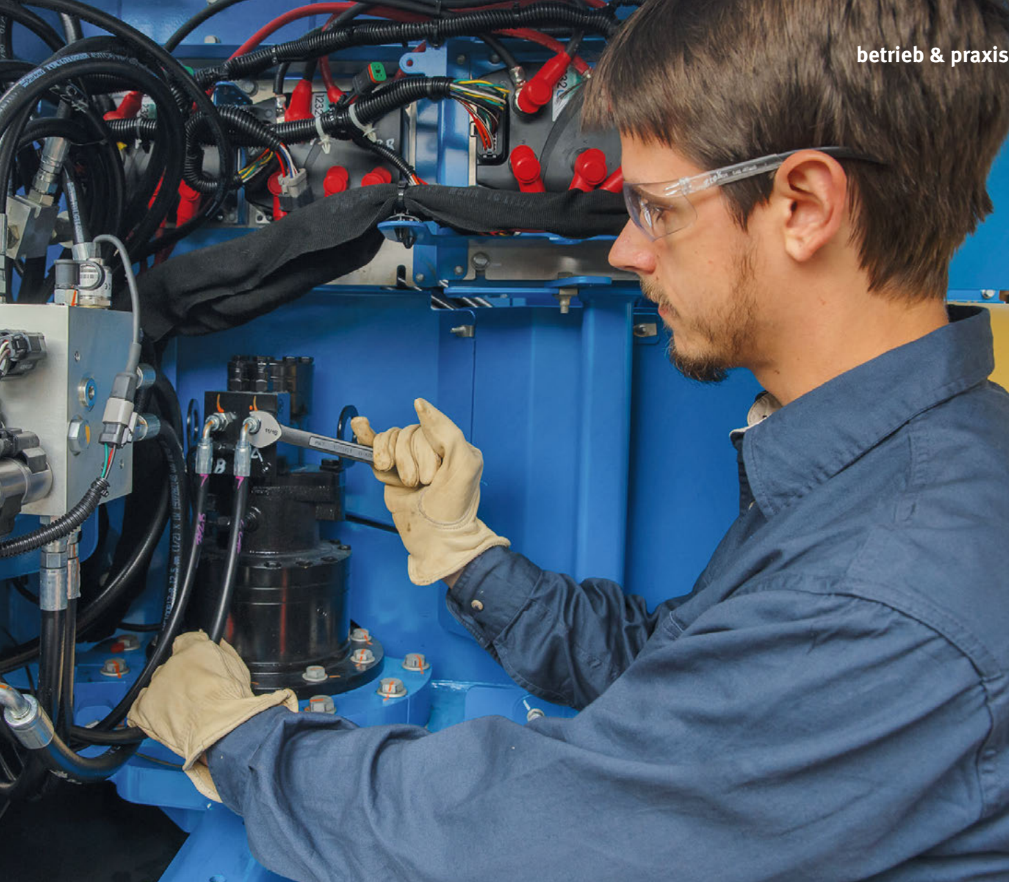
Bei der Instandhaltung von Hydraulikanlagen kann Hydrauliköl unter hohem Druck austreten.
